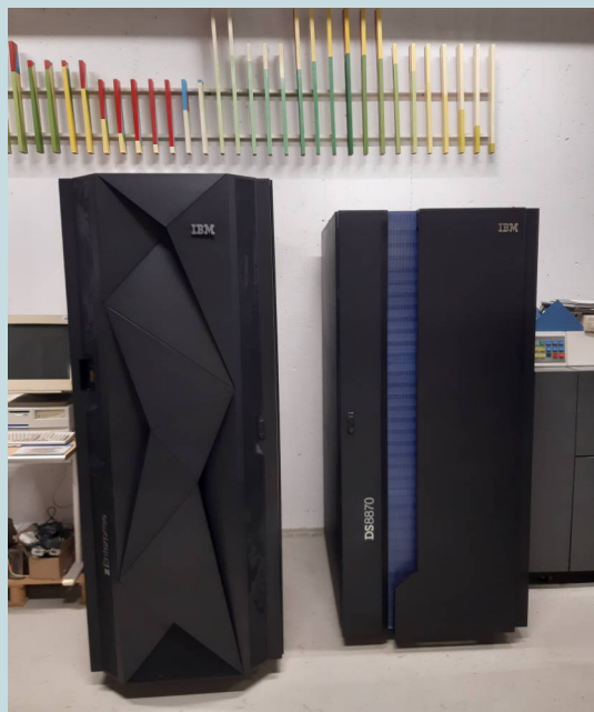
IBM z13 Enterprise systemet til venstre og IBM DS8870 Storage systemet til højre i kælderen i Ballerup
