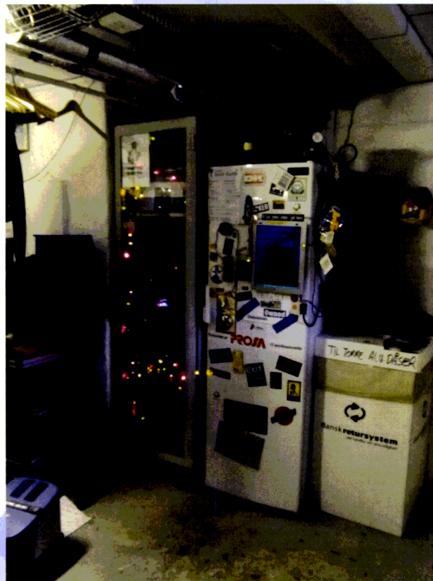
Der er serverskab og køleskab i driftsrummet
