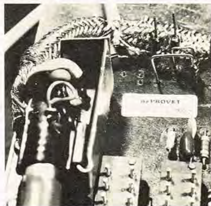
Detailfoto, der viser hvorledes netkablet monteres tæt ved forforstærkeren – risiko for brum.
