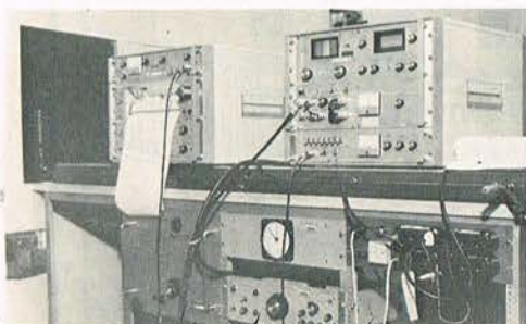
Måleapparatur installeret ved det »radiodode rum« i Danmarks tekniske Højskole, Lundtofte.
