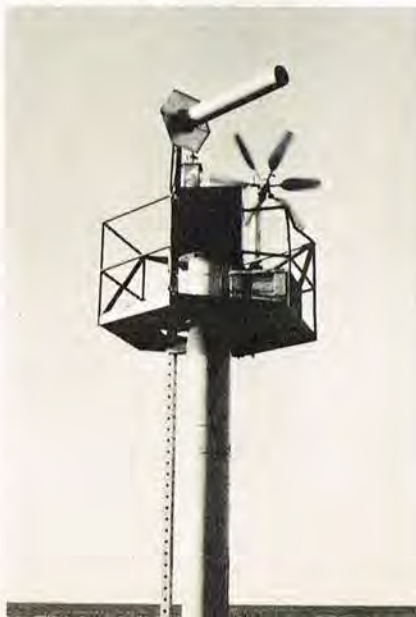
Vest for Højer står denne målestation, udstyret med bølgemåler. Målinger går via Storno-udstyr til overvågningscentralen i Tønder.
