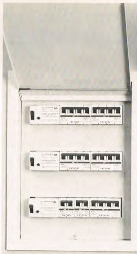
Gruppeafbrydere med HFI-beskyttelse for tre forskellige områder i den elektriske installation.
