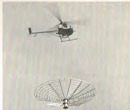
Parabolen på vej op til taget, transporteret af en helikopter fra UNI-FLY.
