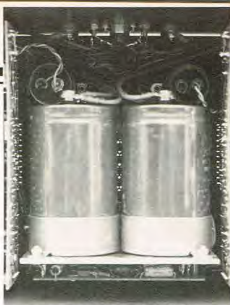
Der er virkelig gods i DR 302 og et kikk ind i dens indre viser også at 'kraftværket' er i orden, men der udvikles meget varme, så god ventilation er påkrævet.
