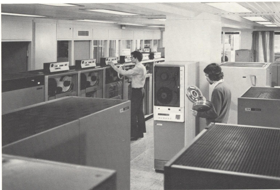
RC 3600 Terminal bei der Sparekassernes Datacentraler, dem Rechenzentrum von Dänemarks größter Sparkasse.
